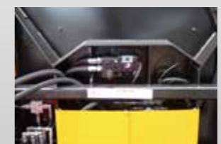
Moteur direct sur la turbine
